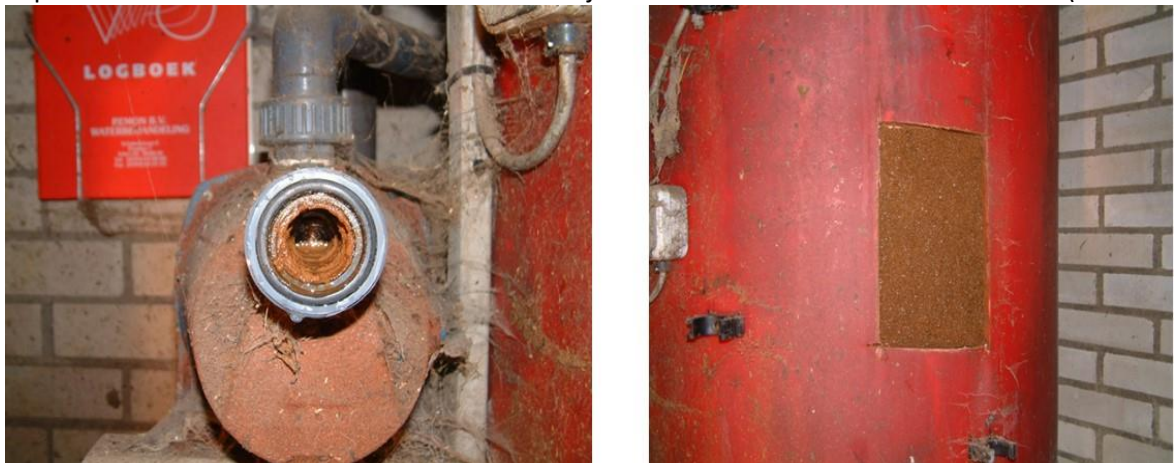
Figuur 23 Ontijzeringsinstallatie die niet meer werkt (links pomp, rechts vat dat open is gezaagd)
