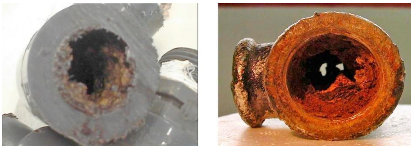
Figuur 13 IJzerneerslag in bocht: links PVC-leiding, rechts leiding van metaal
